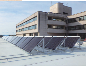
南向きの屋上に据え付けられた太陽集熱パネル
